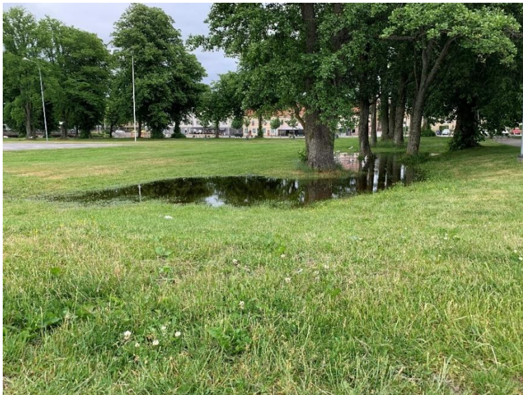
Figur 8 Vid regntillfälle juni 2020 blev vatten stående i lågpunkten inom området i sydöst.
